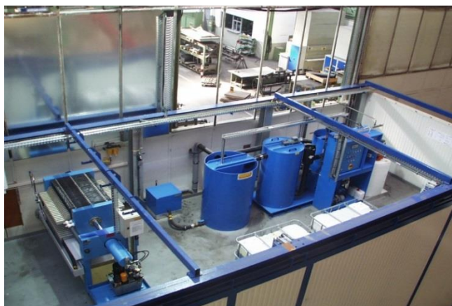
Рисунок 7 – Камерный фильтр-пресс со станцией приготовления полимера
