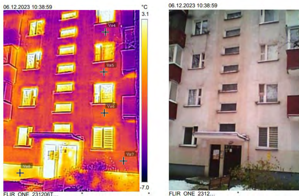
Рисунок 6 – Тепловизионное обследование участка дворового фасада дома
