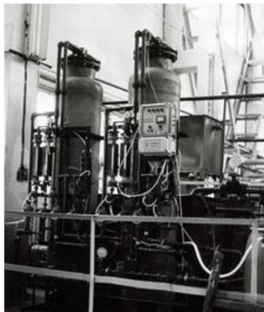
Рисунок 8 – Опытная ионообменная установка, смонтированная на ОАО «БЭМЗ»
