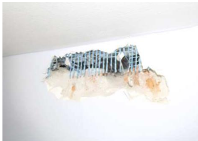
Рисунок 4 – Отсутствие деформационного шва в штукатурном слое перегородок
