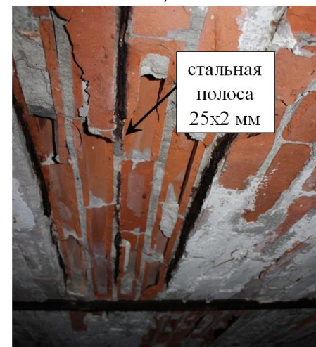
1 – двутавровая балка; 2 – керамический камень; 3 – армирующий элемент; 4 – засыпка; 5 – пол а) легкое; б) среднее; в) тяжелое; г) общий вид обследуемого перекрытия
