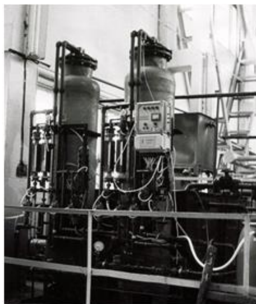
Рисунок 8 – Опытная ионообменная установка, смонтированная на ОАО «БЭМЗ»
