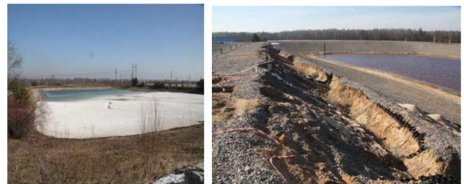
а) пруды накопителя; б) разрушение откосов ограждающей дамбы
