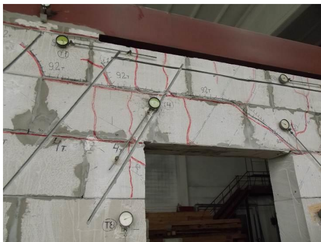
Рисунок 7 – Характер трещинообразования в заполнении
