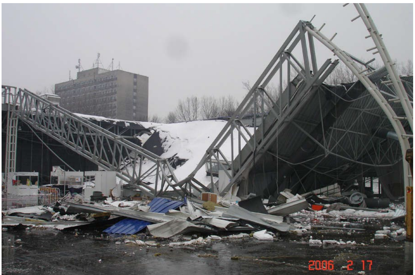
Рисунок 2 – Обрушение крыши выставочного зала г. Катовице, Польша [3]
